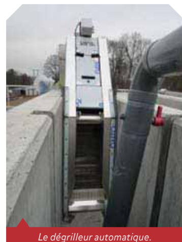
Le dégrilleur automatique.
