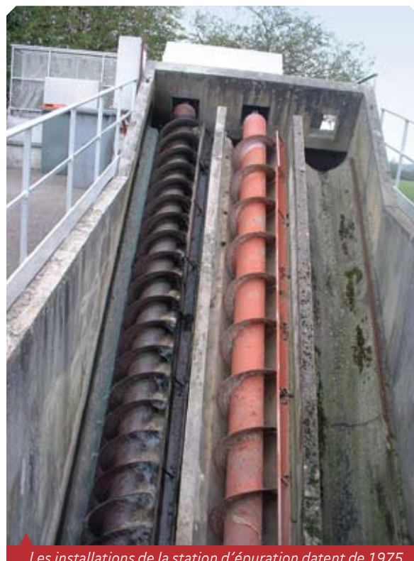
Les installations de la station d'épuration datent de 1975.
